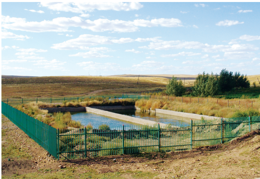
生活污水处理池一角
